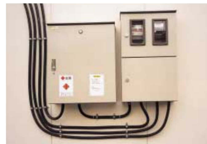
電灯・空調用節電装置
