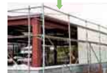
断熱パネル工法 作業者の技量の影響を受けにくい 断熱効果が安定 資材の配送や建設作業が効率的 解体時も資材のリサイクルが可能
