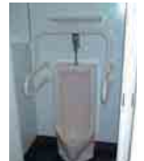
体の不自由な方にも無理なくご利用いただける小便器を設置しています
